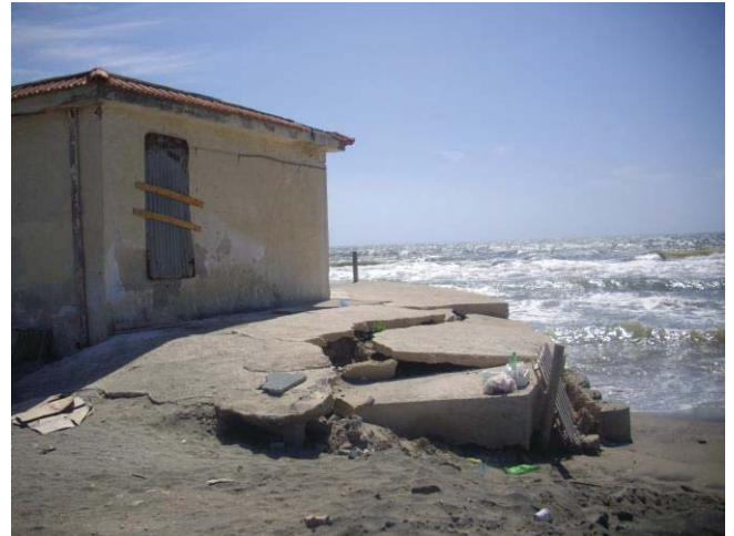
Costruzioni danneggiate dalle mareggiate
